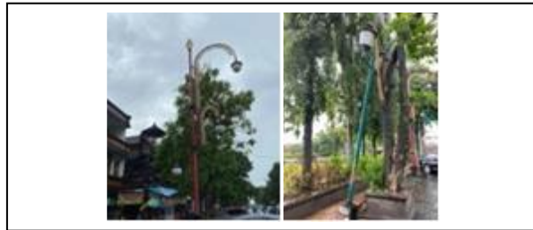
Gambar 12. Lampu Penerangan Jalan Sumber: Dokumentasi pribadi
