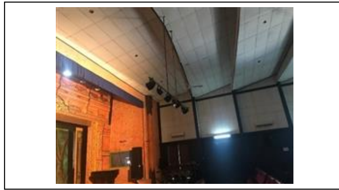
Gambar 12. Plafond Akustik Auditorium RRI Surakarta Sumber: Dokumentasi Pribadi
