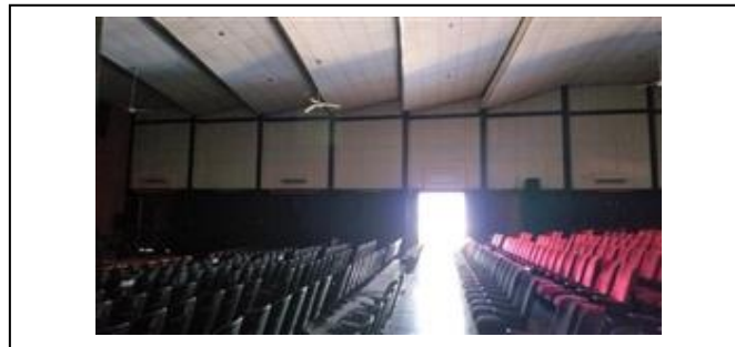
Gambar 16. Sistem Penghawaan Auditorium RRI Surakarta Sumber: Dokumentasi Pribadi
