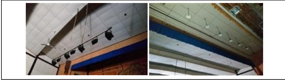
Gambar 15. Sistem Pencahayaan Auditorium RRI Surakarta Sumber: Dokumentasi Pribadi
