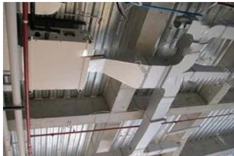
Gambar 11. Instalasi AC Sentral pada FCU Sumber : http://html.scribdassets.com/I3ul62fpc479nx0/images/72-e07157a8f7
